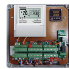
Steuereinheit mit Platine, Transformator und Klemmenblöcken
